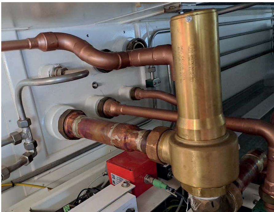
Valvola di sicurezza installata su un impianto biogas
