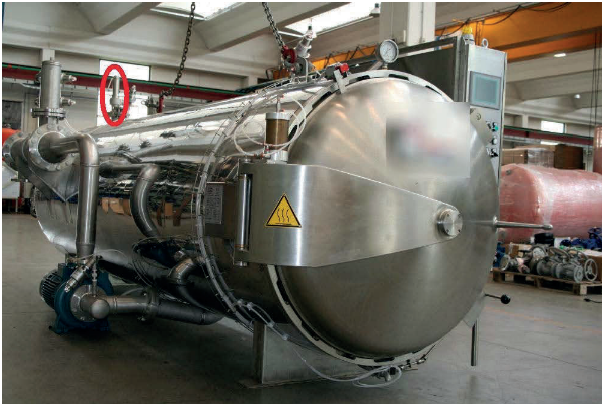
Valvola di sicurezza installata su generatore di vapore
